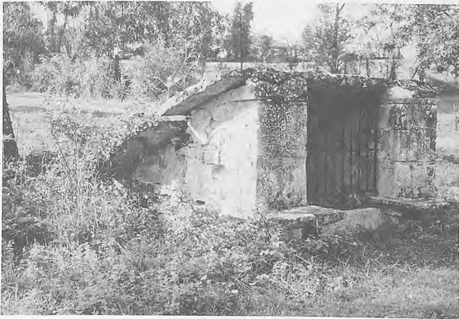
La font a le double sens de source et de fontaine, en occitan. On y va puiser l'eau potable, mais l'eau captée alimente souvent un lavoir comme ici au Mas de Cajarc.
